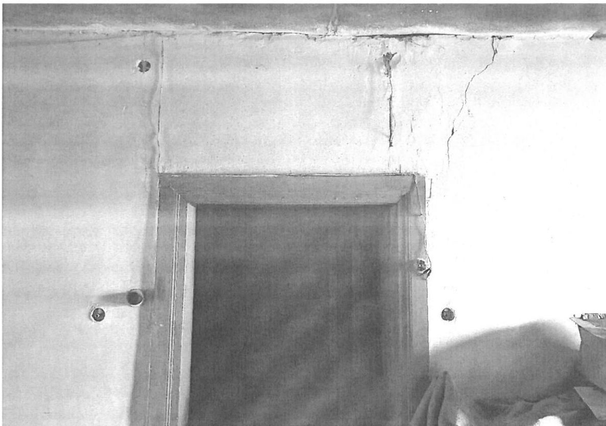
LAKÓRÉSZ 3: BELSŐ KERESZTIRÁNYÚ FAL AJTÓNYÍLÁS FÖLÖTTI REPEDÉSE
