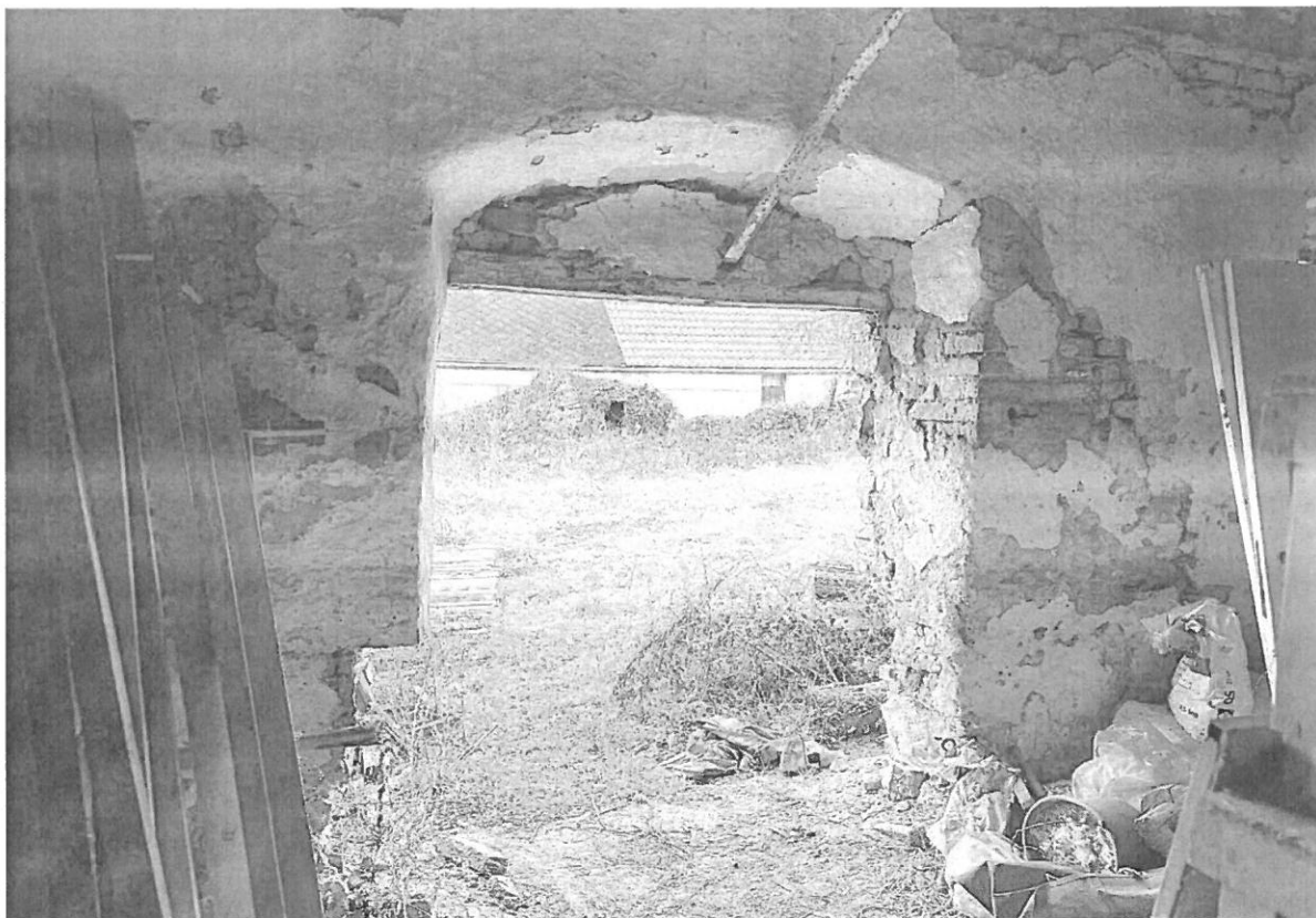
GAZDASÁGI ÉPÜLETRÉSZ BEJÁRATA BELÜLRŐL : CSAK MERÉSZ EMBEREKNEK!
