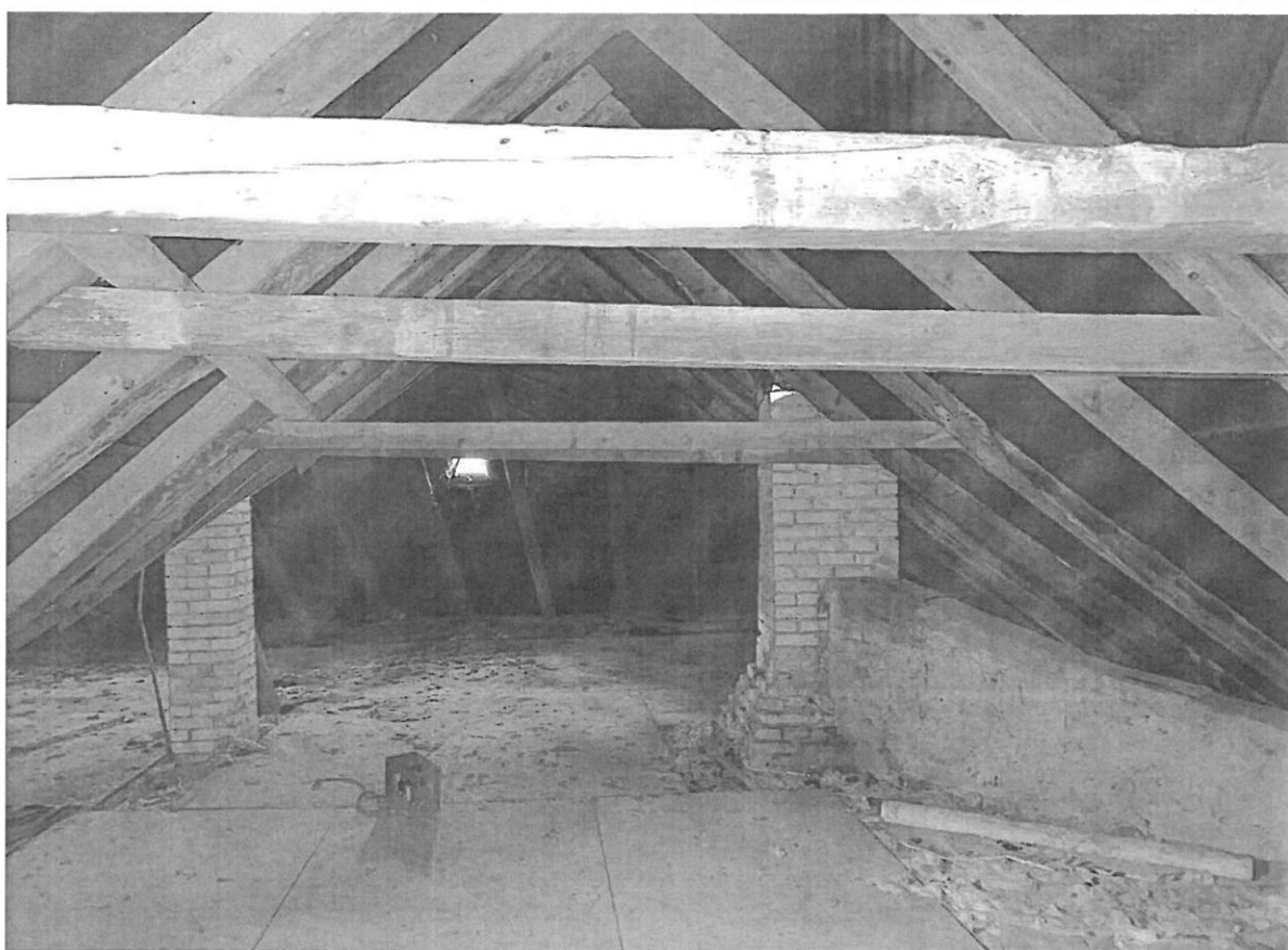
A LAKÓRÉSZ FÖLÖTTI ÚJJÁÉPÍTETT TETŐSZERKEZET, A KÉMÉNYNÉL LÁTHATÓ (MEGEN- GEDHETETLE) FÉNYRÉSSSEL.
