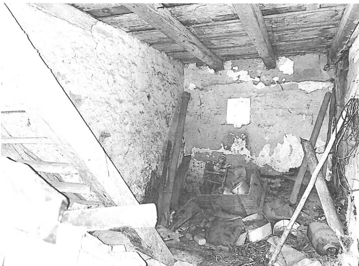
GAZDASÁGI ÉPÜLETRÉSZ MEGSÜLLYEDT PADLÁSFÖDÉME, ÉS FINOMÁN SZÓLVÁ IS KÉT- SÉGBEEJTŐ BELSŐ KÉPE
