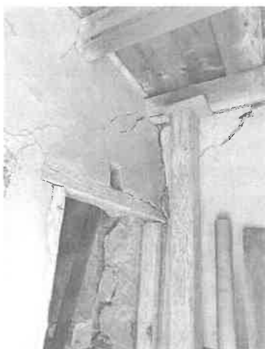
A repedés egy része a lakóház felől
