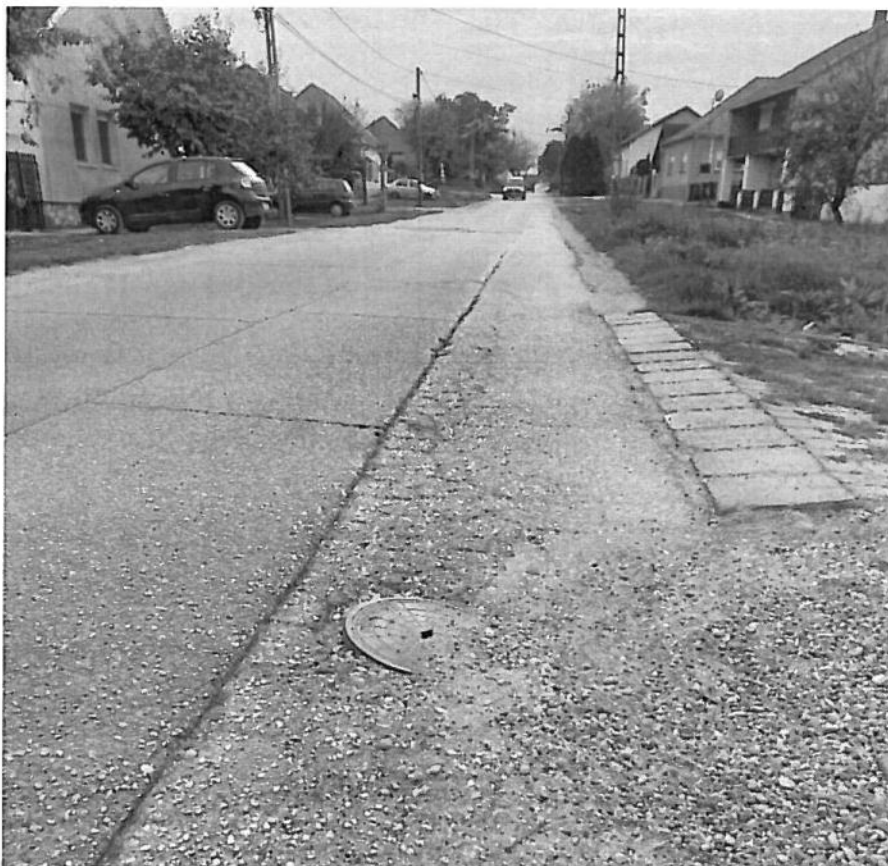
18. kép: Megsüllyedt csatornafedlap és kátyúsodás a Móricz Zsigmond utca 42. sz. előtt, 2022. októberében
